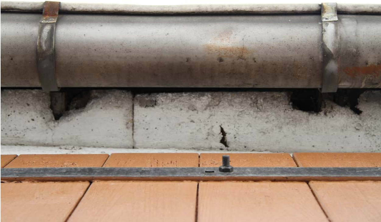
Abb. 6: beschädigte Betonhohldielen mit dahinterliegenden Hohlräumen
